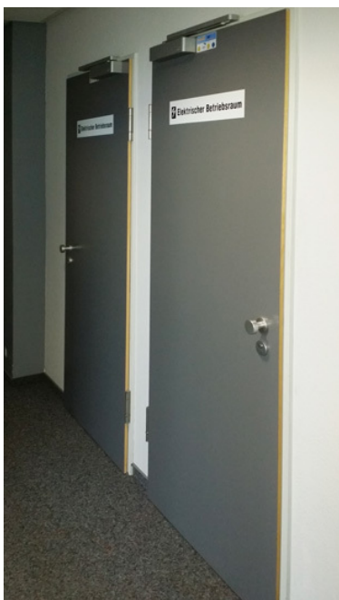
Abb. 10: Türen in einem notwendigen Treppenraum
