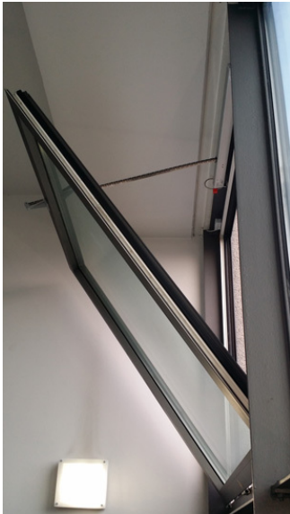
Abb. 8: Öffenbares Fenster in einem Treppenraum
